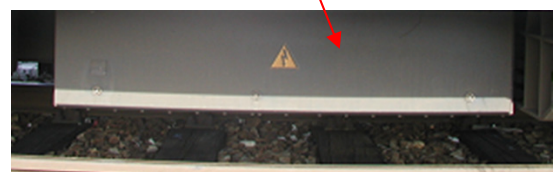
Batteriesicherungen im geschlossenen Batteriekasten
