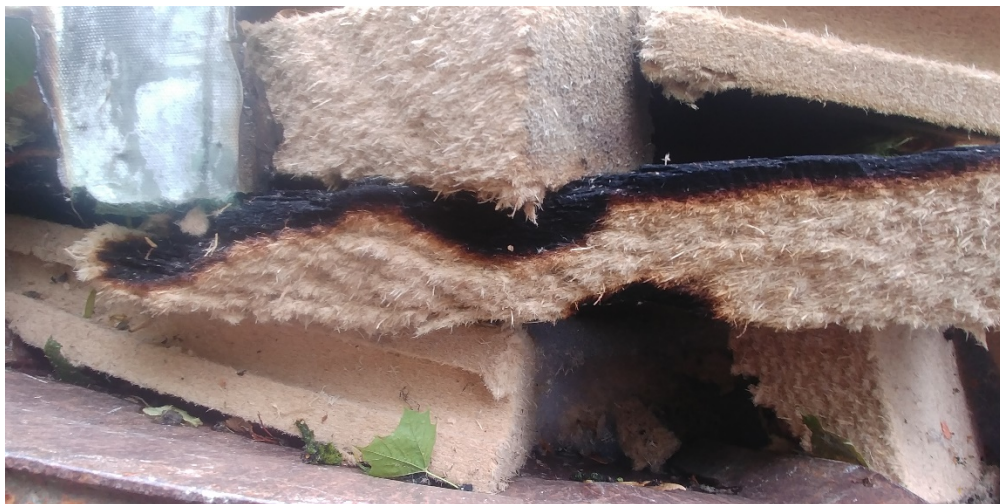
Abbildung 2: Holzfaserdämmplatten nach Brandeinwirkung (Branddirektion München)
